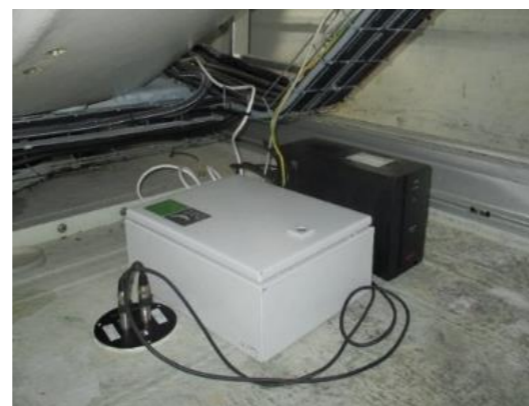
BATmode S (détecteur enregistreur automatique à ultrasons) installé dans la nacelle de E6 du parc éolien d'Escardes en exploitation (G. Marchais, Ecosphère)
